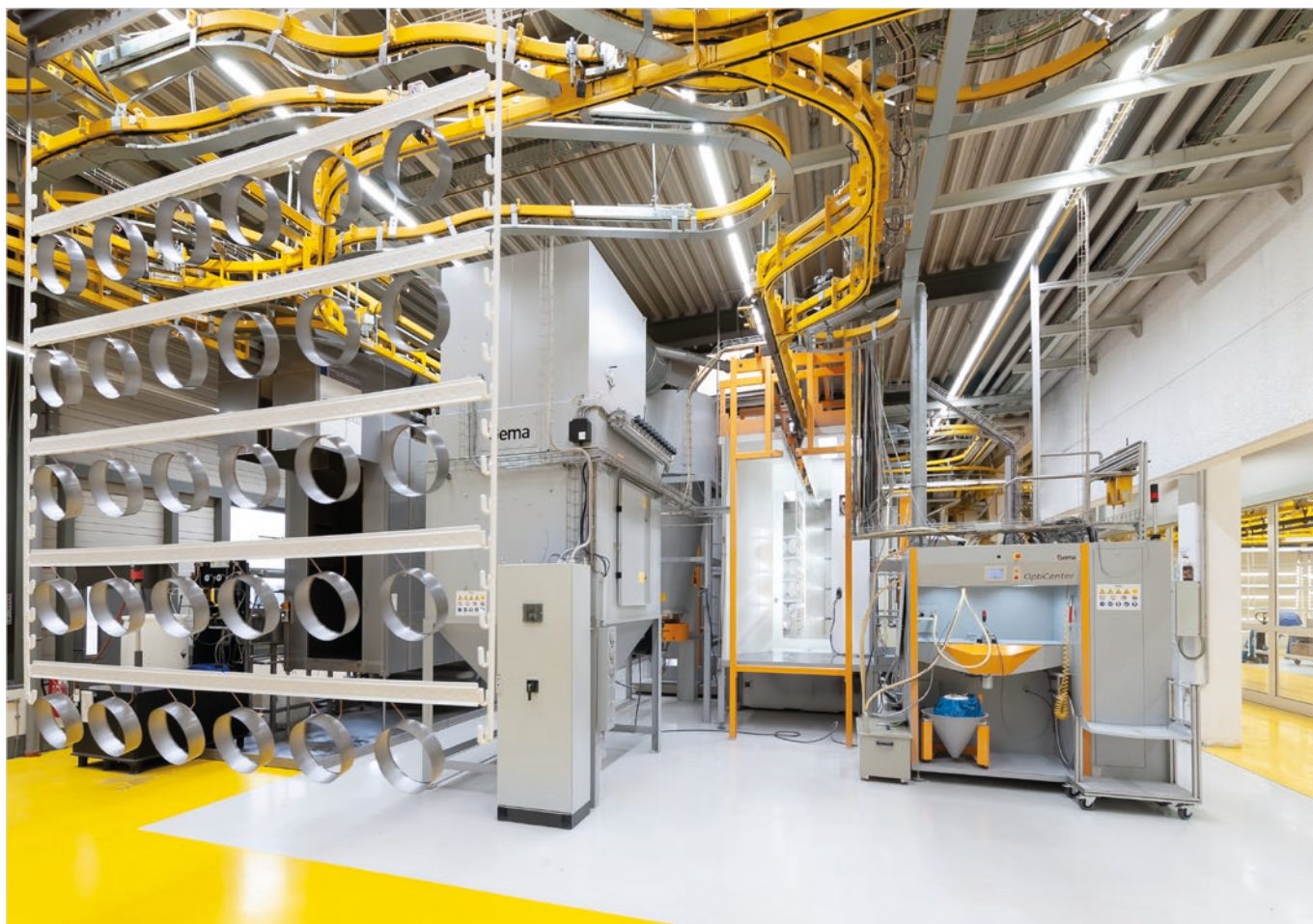
Centro de pintado por revestimiento al polvo
